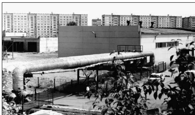
Подкачивающая насосная станция.
